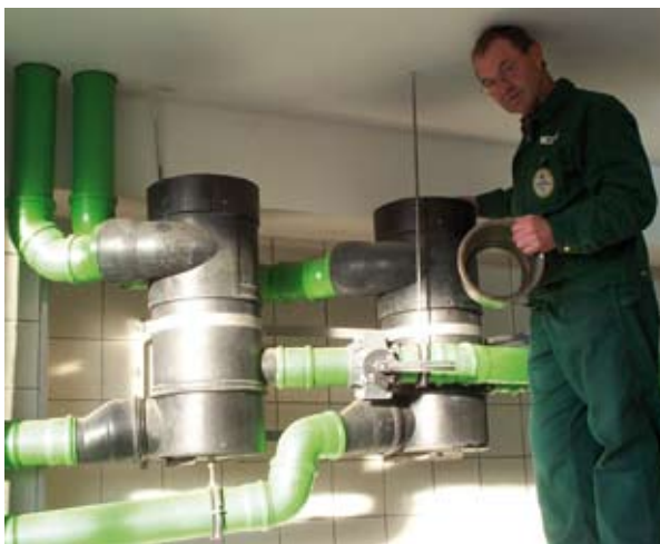
Blick auf die Filteranlage
