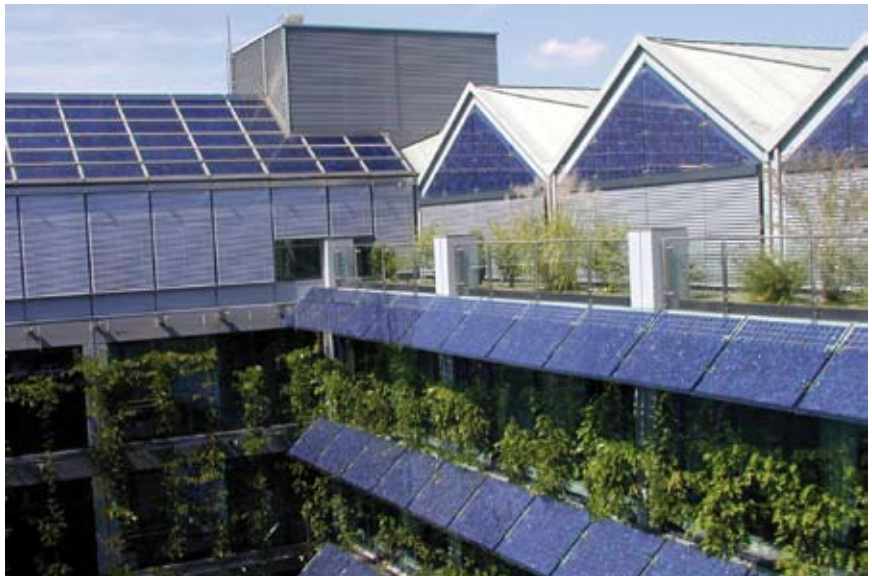
Photovoltaik-Module auf dem Dach des Gebäudes der BayernLB
