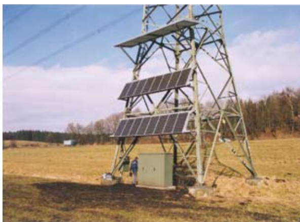
Mobilfunksender mit Solaranlage
