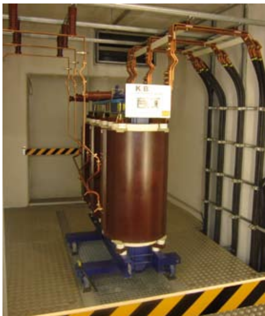
Einer der 107 Transformatoren
