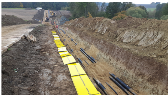
Abb. 1: Wiederverwendung von Bodenaushub beim Verlegen von Erdkabeln. Hier wurde der Oberboden (links) vorbildlich vom Unterboden (rechts) getrennt und im Anschluss wieder lagenweise eingebaut.
