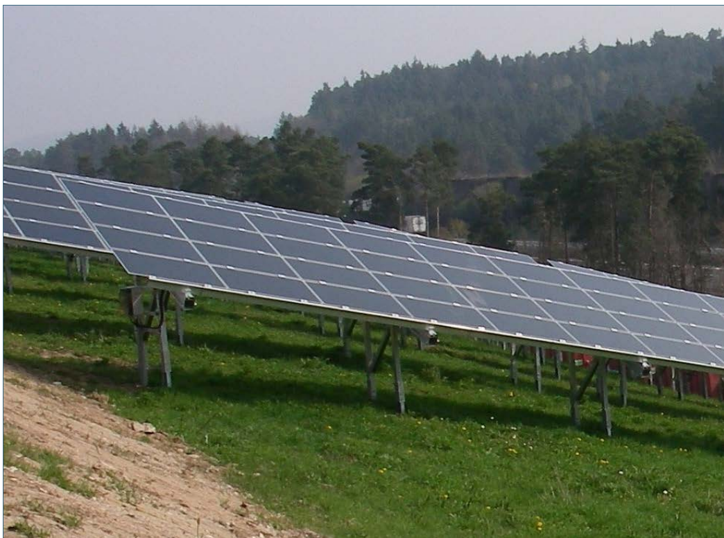
Abb. 1: PV-Module auf einer Deponie
