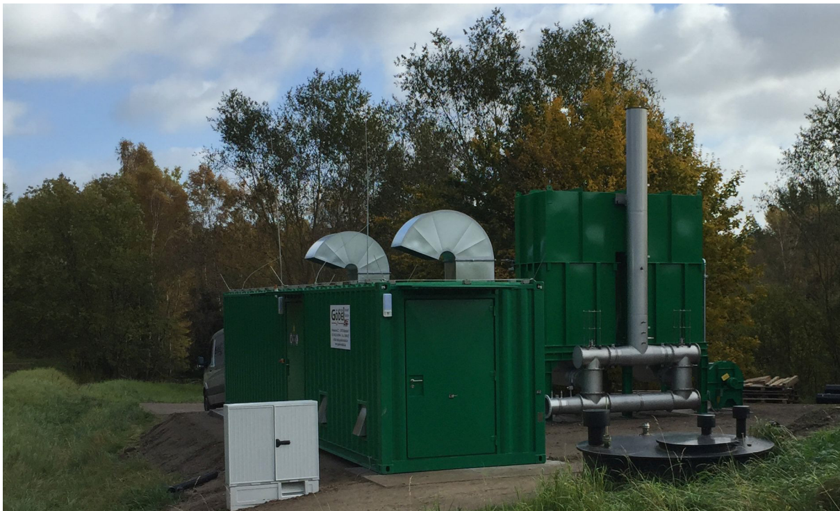
Abb. 10: Gasverdichterstation mit RTO für ein Deponiebelüftungsprojekt
