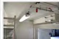
Notdusche mit 250-Liter-Tank und ex-Beleuchtung
