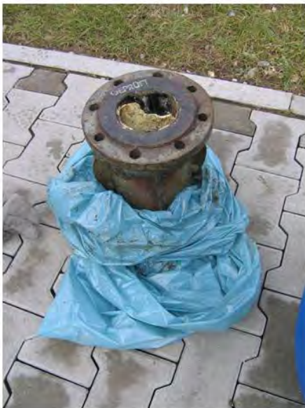
Rohr aus Abkühlstrecke
