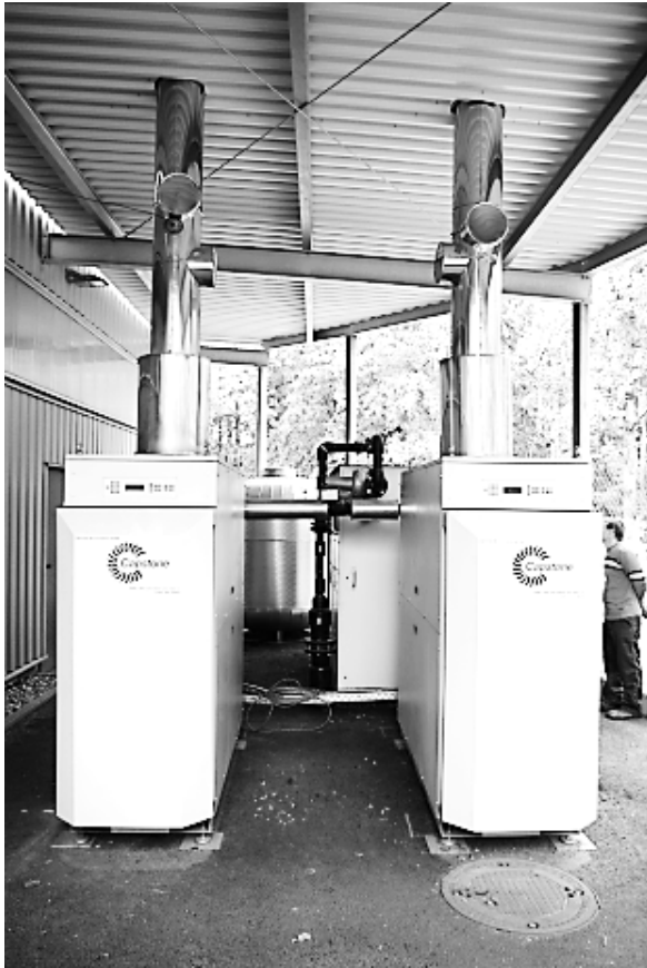
Abb. 5: Turbinenanlage auf der Deponie Eichelbuck
