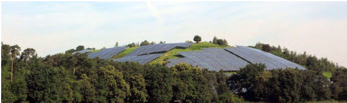
Abb. 3: Ansicht der PV-Anlage
