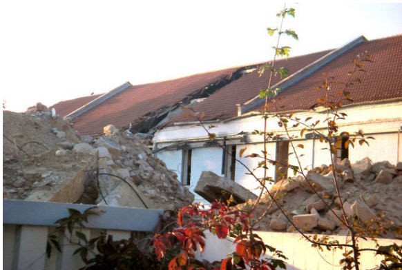
Abb. 23: Abbruch eines Gebäudekomplexes... Dieser Abbruch erfolgte ohne Ansätze einer Bewahrung von Gebäudestrukturen in der Neuplanung oder von Bauteilen.
