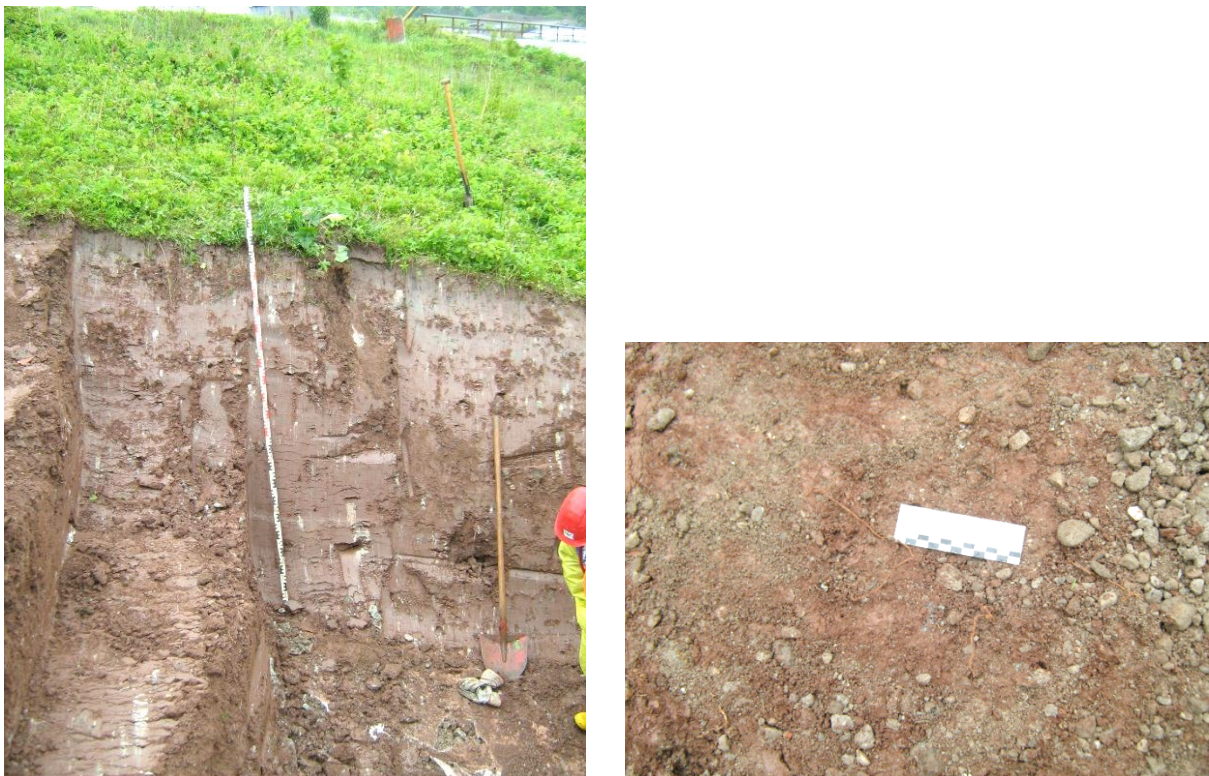
Abb. 1: Aufgrabung des Versuchsfeldes E 35 (Deponie „Im Dienstfeld“, Aurach); linkes Bild: Schurf durch die 2,0 m dicke Rekultivierungsschicht; rechtes Bild: freigelegte Oberfläche der mineralischen Dichtung mit eingewachsenen Wurzeln.
