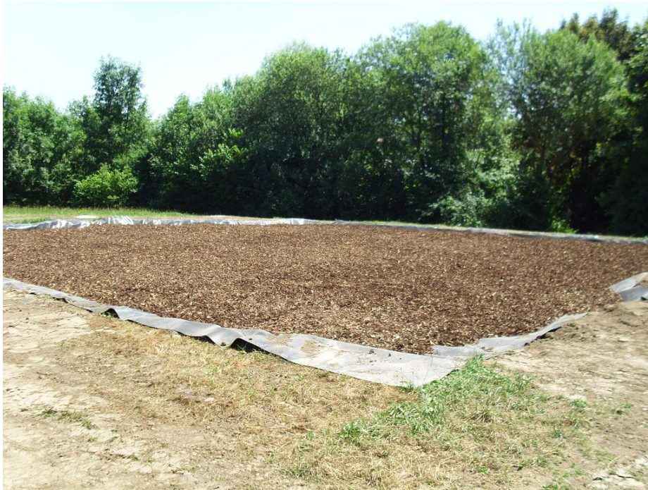
Abb. 4: Ansicht des in die Rekultivierungsschicht eingebundenen Biofil- ters
