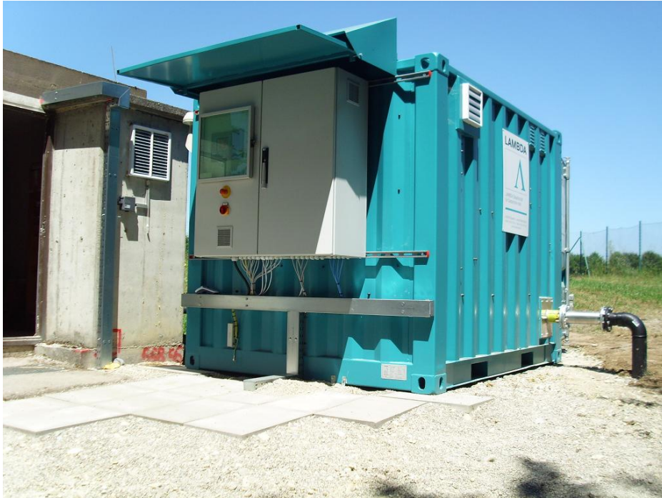
Abb. 3: Neue Gasförderanlage in Containerbauweise, rechts Abgang zum ortsfesten Biofilter
