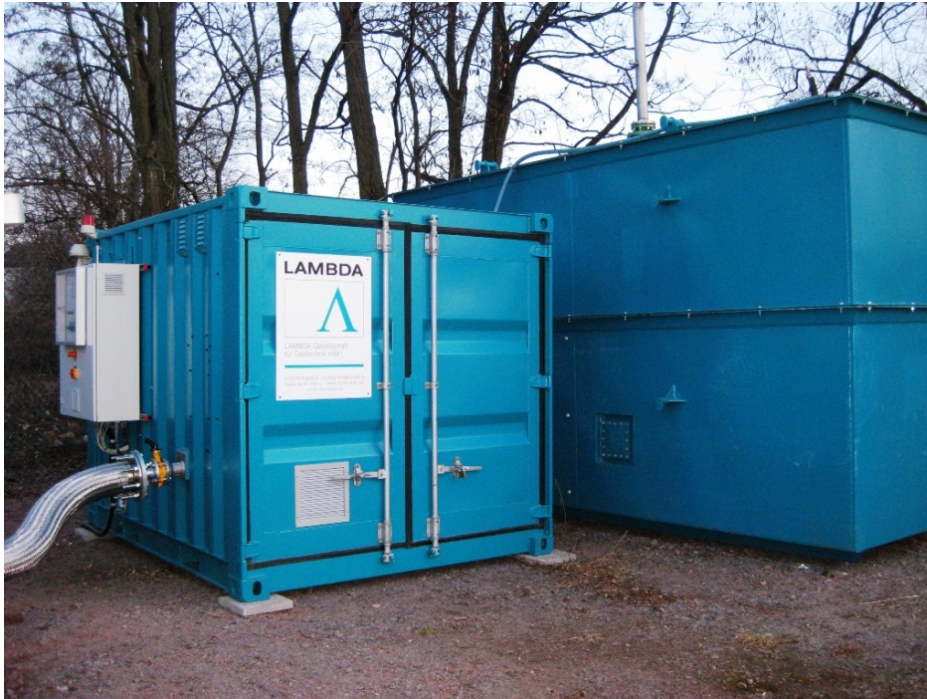
Abb. 2: Anlage zur Förderung und Behandlung des Deponieschwachgases
