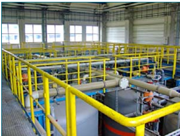
Abb. 5: GSB München – Innenansicht der chemisch-physikalischen Behandlungsanlage
