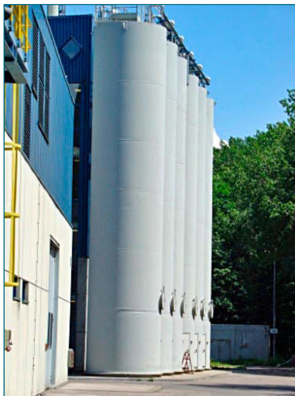
Abb. 8: GSB Baar-Ebenhausen – Endkontrollbehälter der Abwasserreinigungsanlage
