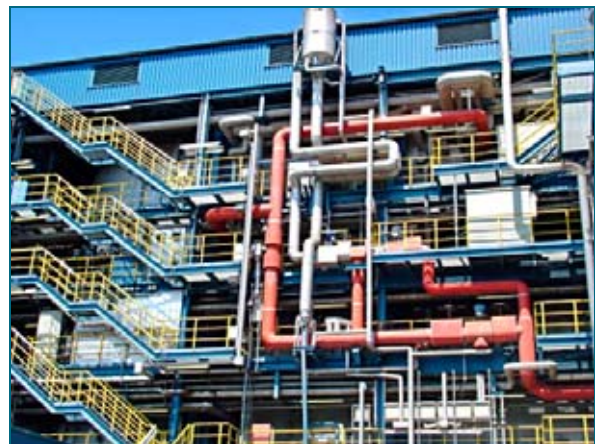
Abb. 6: GSB Baar-Ebenhausen: Sonderabfallverbrennungsanlage
