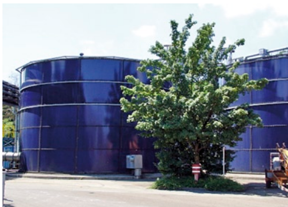
Abb. 5: Biologische Abwasserreinigung der GSB-Sonderabfallverbrennungsanlage
