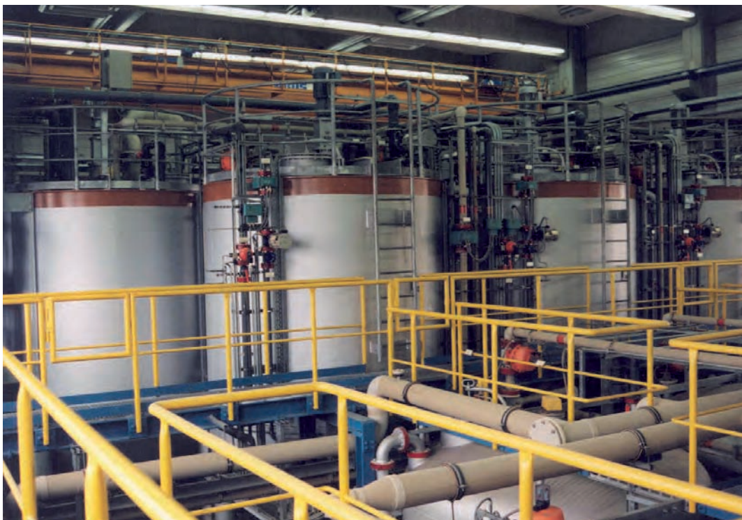
Chemisch-physikalische Behandlungsanlage der GSB in München
