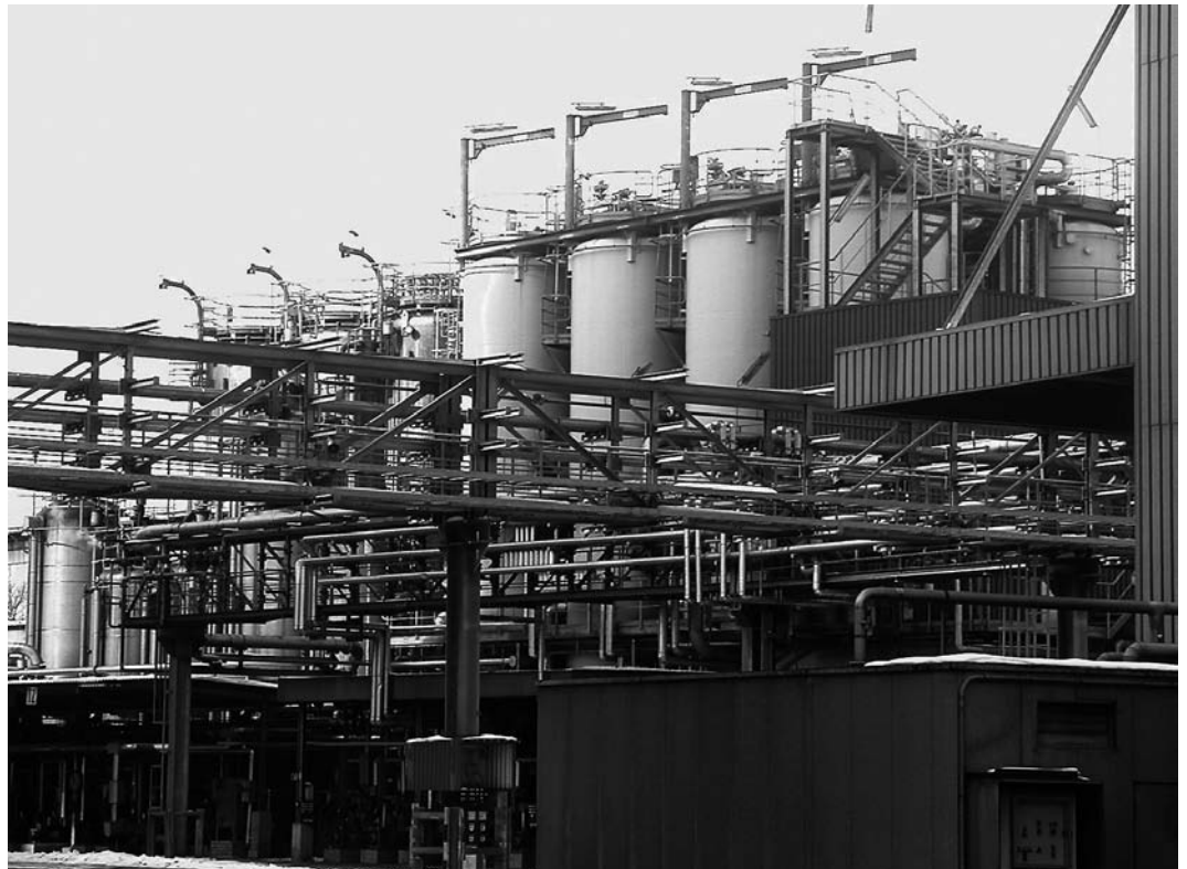
Flüssigtanklager der GSB
