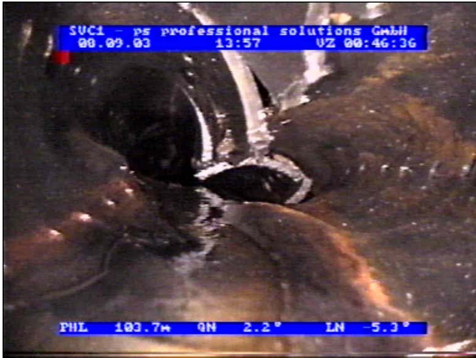
Abb.12: Einsturz einer gelochten PE-Leitung
