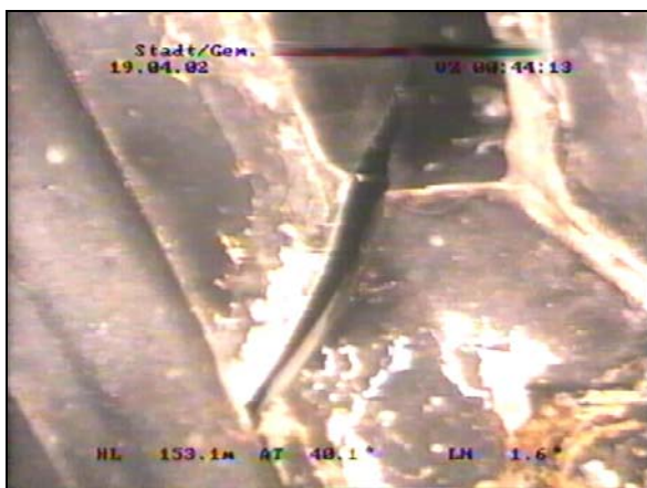
Abb. 9: Riss ausgehend von einem Schlitz
