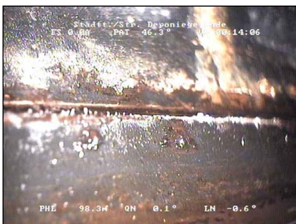
Abb. 11: Riss in der Rohrsohle einer PE-Leitung
