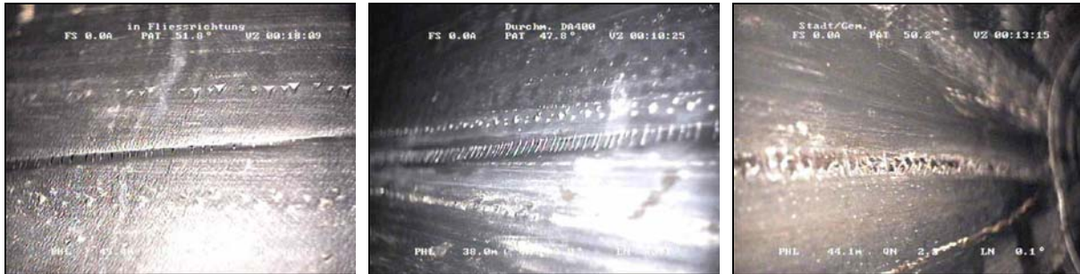
Abb. 6 bis 8: Entwicklungsstadien der Rissbildung in biegesteifen Rohren
