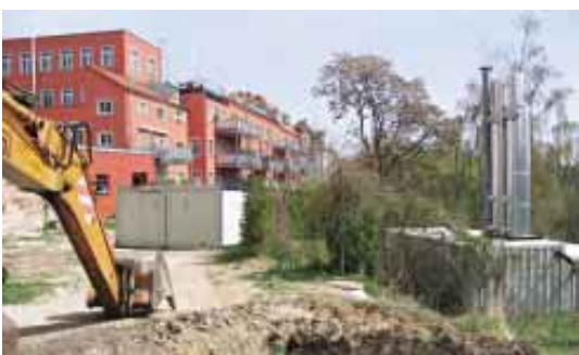
Container mit einer Grundwassersanierungsanlage neben der Neubebauung
