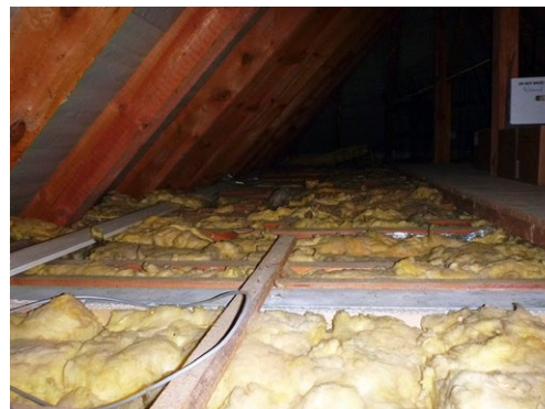
Mitte links: Polystyrol Dachdämmung unter teer- und asbesthaltiger Dachpappe
