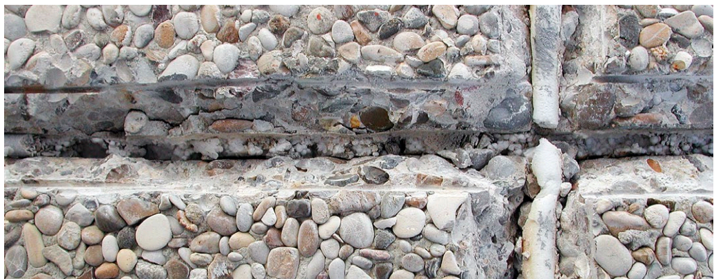
Ausgeschnittene polychlorierte Biphenyl (PCB)-Fugenmassen: Die Fugenflanken müssen auf Sekundärkontaminationen untersucht werden.
