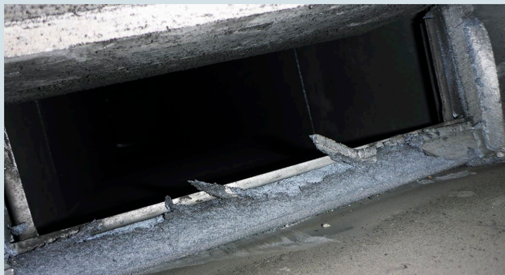
Brandschutzklappe mit stark beschädigter asbesthaltiger Anschlagdichtung
