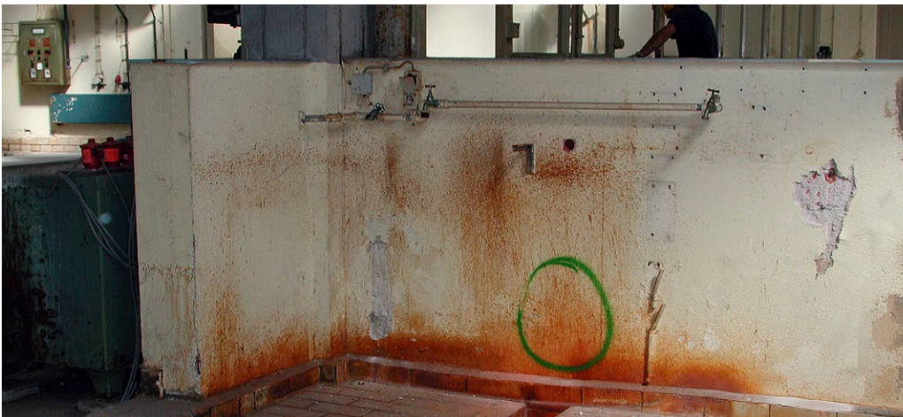
Kontamination aus der Gebäudenutzung
