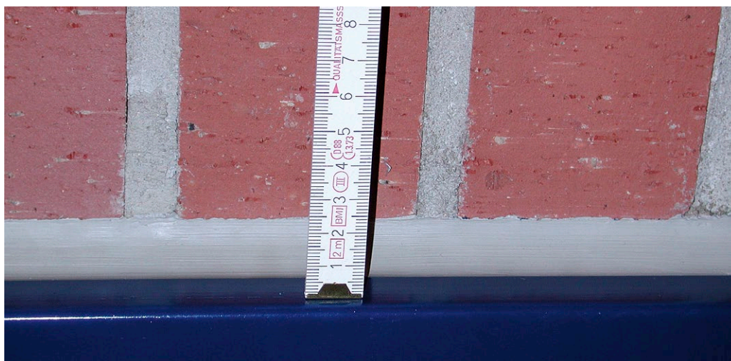
Elastische Fugenmasse mit PCB-Verdacht
