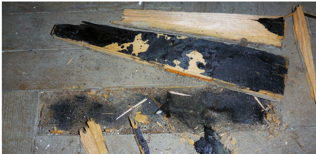
Unten: Holzparkett mit teerhaltigem Kleber und teerhaltiger Filzzwischenlage
