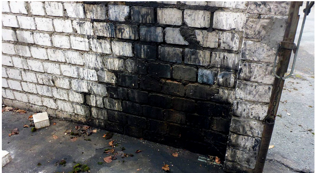
Nutzungsbedingte Mineral- ölkohlenwasserstoff (MKW)- Verunreinigung
