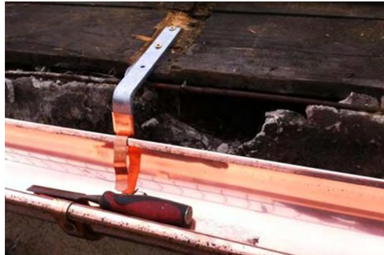
Abb. 3: Die große Ausbruchstelle nutzen Mauersegler, um in den Traufkasten zu gelangen; bautechnisch sind solch große Ausbrüche ein Problem, da Feuchtigkeit eindringen kann.
