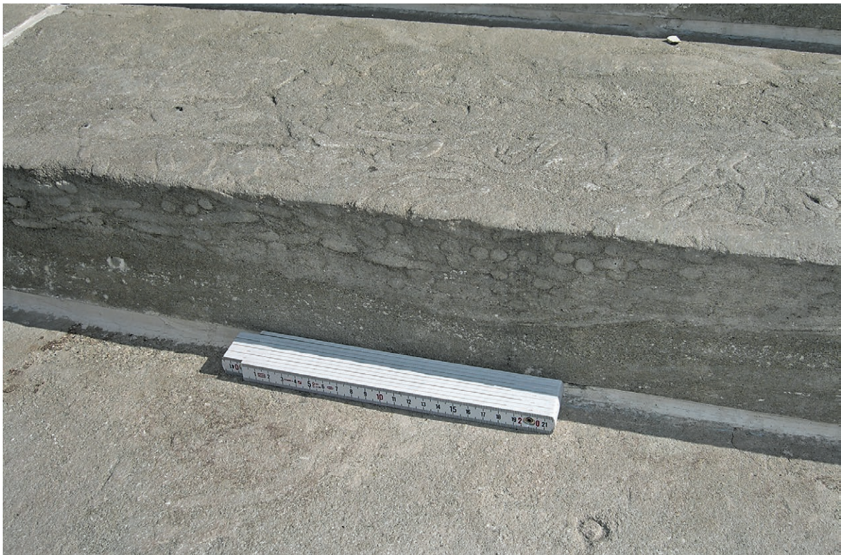
Abb. 30: Treppenstufe zur Kelheimer Befreiungshalle aus Grünsandstein mit Wurm Spuren im Längs- und Querschnitt.
