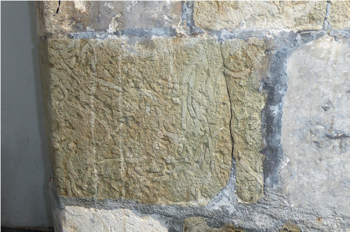
Abb. 31: Mauerstein mit Wurmspuren, Stadtturm in Straubing.
