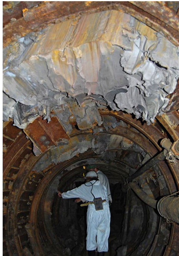
An vielen Stellen ist der enorme Gebirgsdruck zu sehen. Eingebrochene Hölzer oder Eisenverbauungen werden immer wieder durch dahinter hervorquellenden Ton zerbrochen, der sich selbst durch kleine Ritzen oder Spalten drückt.
