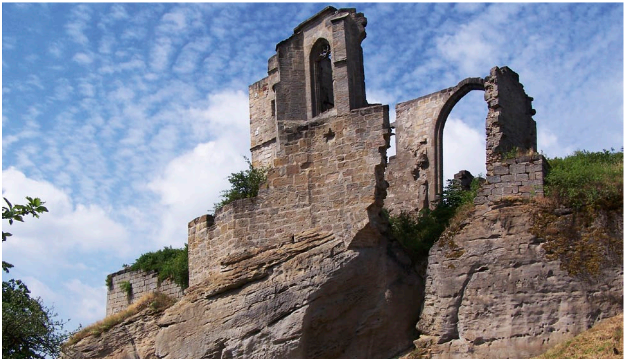
Die Burgherren von Altenstein hielten den Baugrund ihrer im 13. Jahrhundert errichteten Burg für stabilen Fels. Wegen dem schmierigen Feuerletten-Untergrund gleitet allerdings ihr Heim beständig hangabwärts: Risse in der Mauer und die schiefen Wände zeigen dies deutlich.
