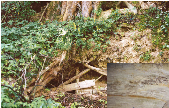
Verfallenes Stollenmundloch des ehemaligen Bergwerks Pranzmühle
