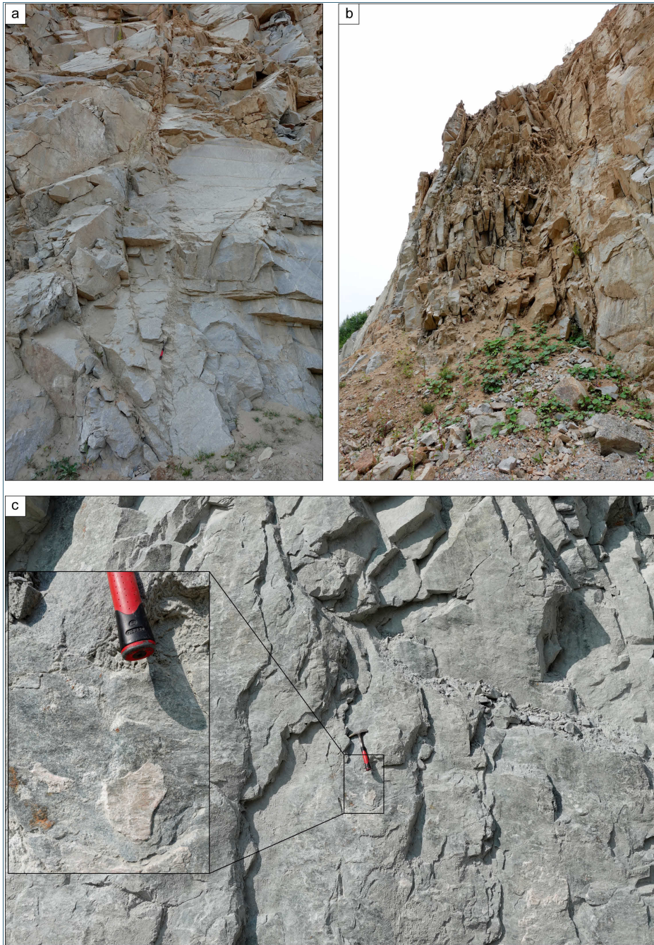
Abb. 3: Hier sind ausgewählte Ansichten von Zerrüttungszonen im Steinbruch Wotzdorf zu sehen. Wie in (a) zu sehen, kann das Gestein in schmalen Bändern (<10 cm) oder breiten Abschnitten (etwa 2 m), wie in (b), zerlegt sein. Auf Flächen, die parallel zu der Zerrüttung in (b) streichen, sind häufig Calcit-Faserharnische zu finden, wie in (c) dargestellt.
