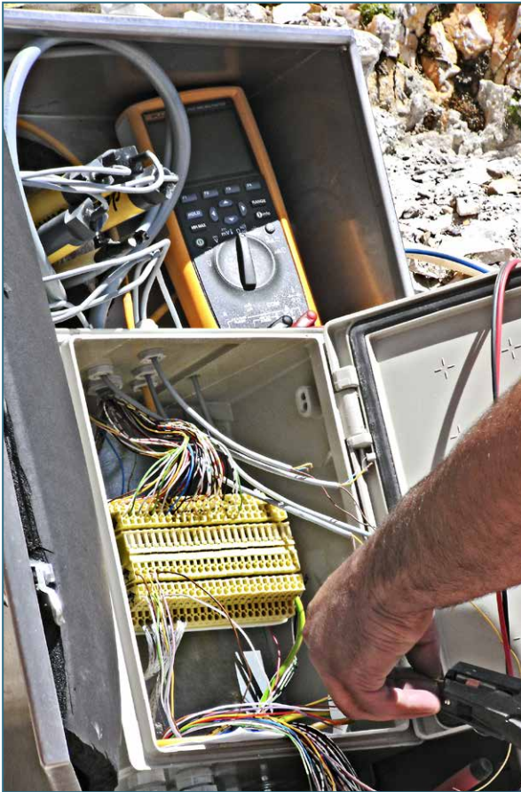
Abb. 3-9: Elektro-Schaltschrank auf dem Bohrkopf mit Blitzschutz-Installation.
