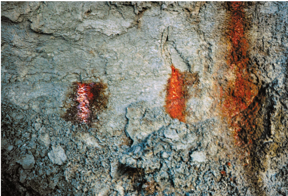
Abb. 2. Deponiesickerwasser (braun verfärbt) tritt über einer Tonschicht (obere Abb.), aber auch aus feinsten Klüftchen innerhalb der Tonschicht (untere Abb.) aus. – Fotos: OELTZSCHNER 1993.
