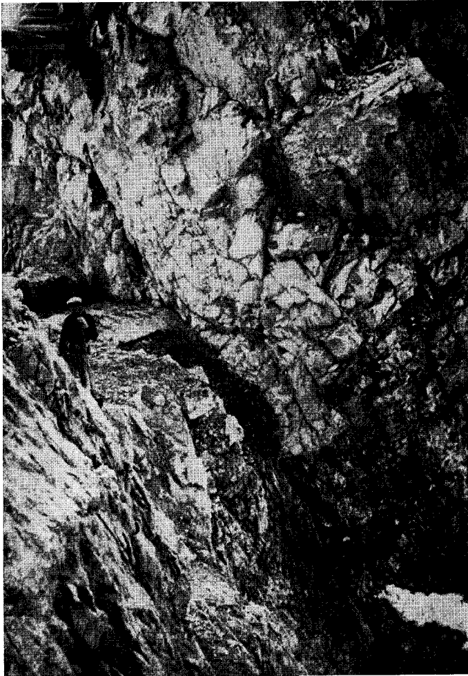
Abb. 7. Felszustand an der Nordseite der Westeinfahrt; Fundament im Punkt P (siehe Abb. 9) in Bildmitte. Aufnahme: W. Vogt
