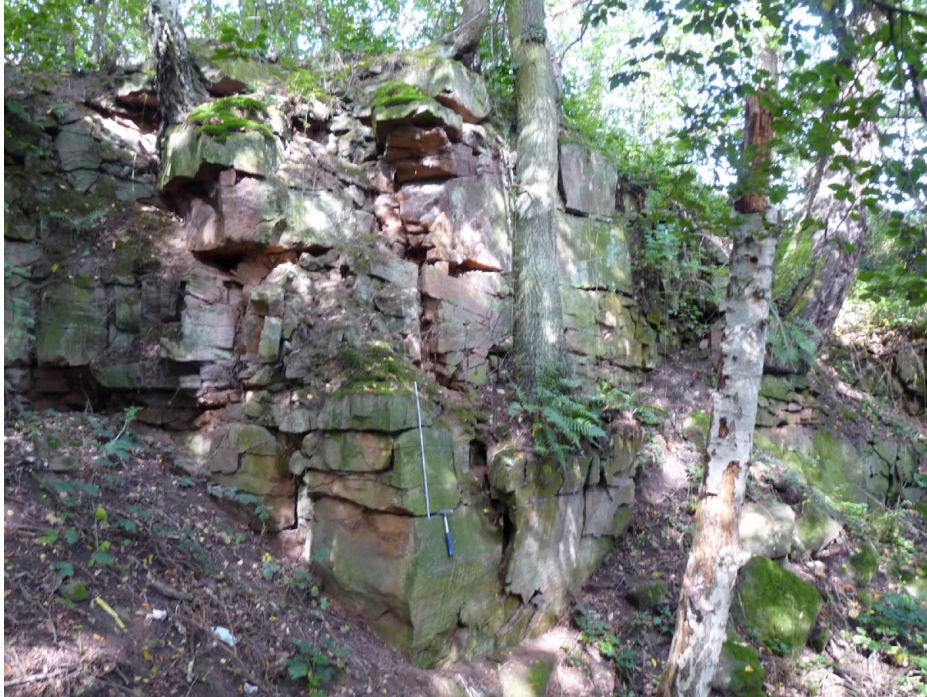
Abb. 17: Ehemaliger Abbau im Rötquarzit E Roßhof. Der hier schwächer quarzitisch gebundene, gleichmäßig feinkör- nige, aber dennoch spröde Sandstein son- dert in bis meterdicken, teils ruppigen Bänken ab (Größenvergleich: ein Meter Zollstock in Bildmitte).
