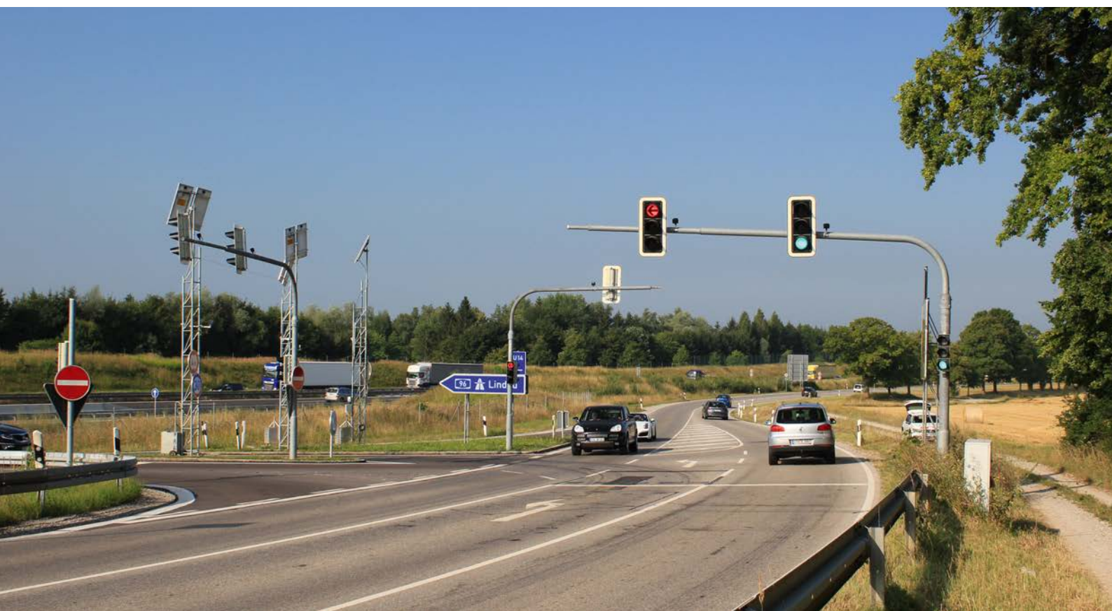
Lichtsignalanlage mit intelligenter Steuerung und gut sichtbaren LED-Signalen
