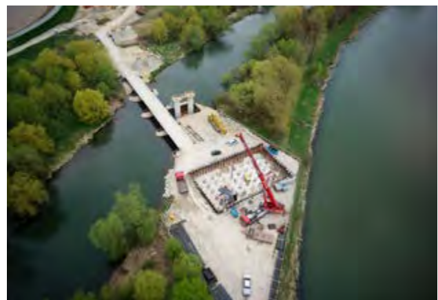
➤ St 2124, Ortsumgehung Plattling, Neubau der Isarbrücke mit Einheben der ersten Stahlteile am Kämpferfundament
