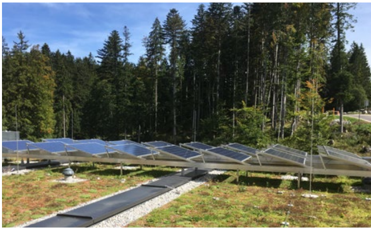
Photovoltaik-Anlage auf dem begrünten Dach einer Seilbahnstation Quelle: StMB
