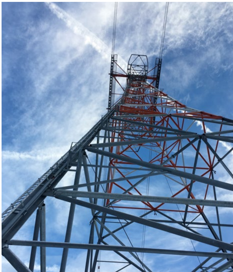
Seilbahnstütze Quelle: ROTEC
