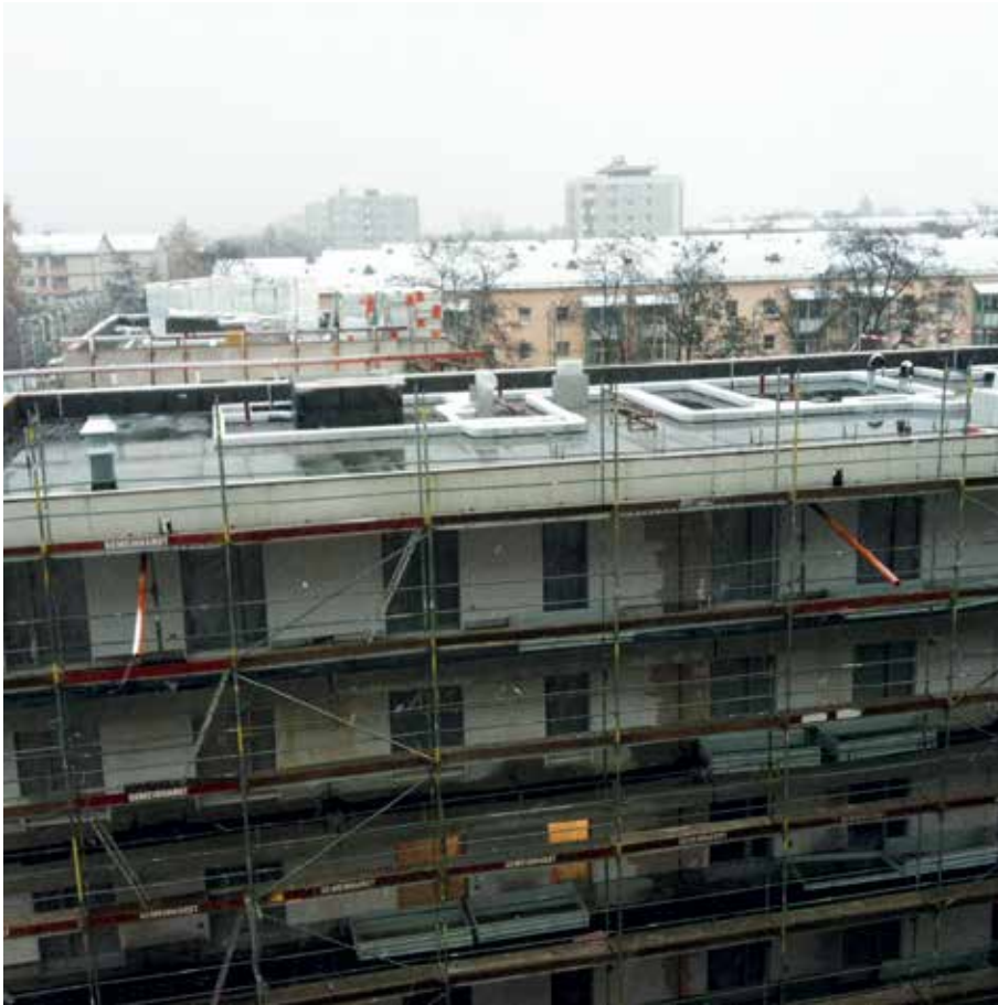
Abb. 125: Lüftungsleitungen auf dem Dach vor der Überdämmung
