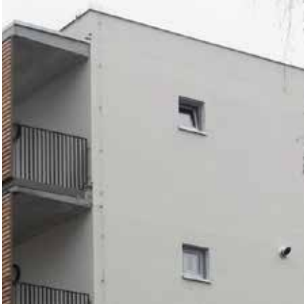
Abb. 168: Gekipptes Fenster in Marktrechwitz
