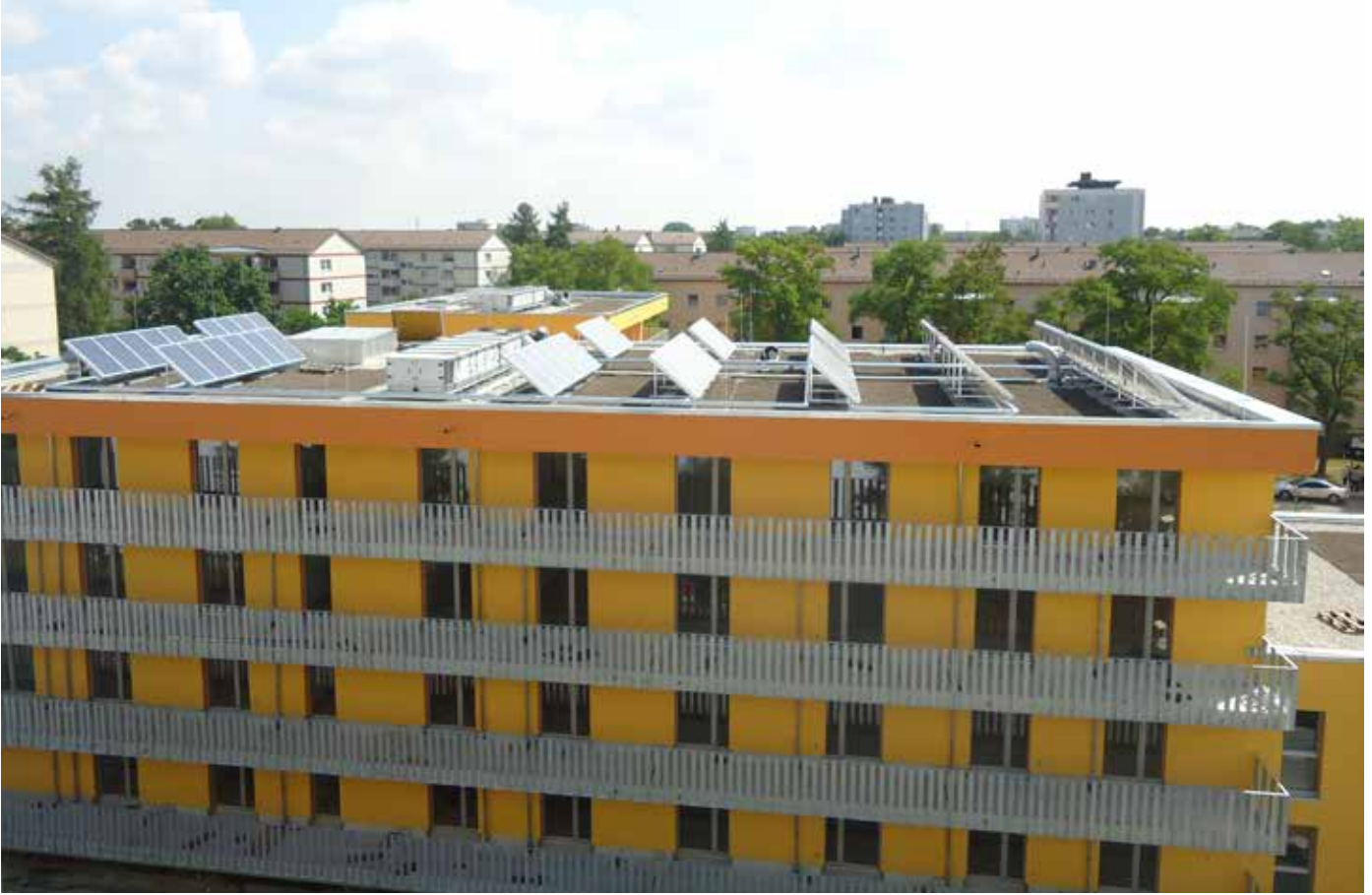
Abb. 124: Technikkomponenten auf dem Dach
