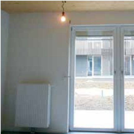
Abb. 79: Wohnzimmer mit Heizkörper
