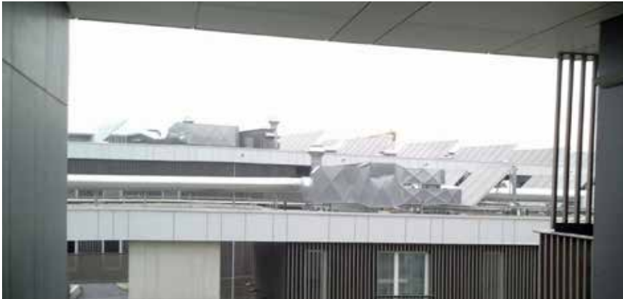
Abb. 71: Aufsicht auf den sogenannten Energiebügel mit Lüftungs- und Solarthermieanlage
