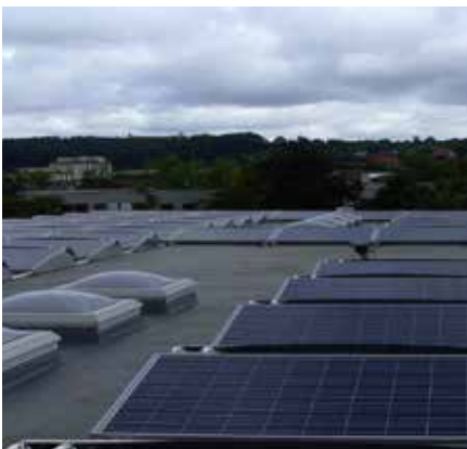
Abb. 161: Photovoltaikanlage in Ansbach
