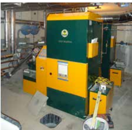
Abb. 40: Pelletkessel im Kellergeschoß
