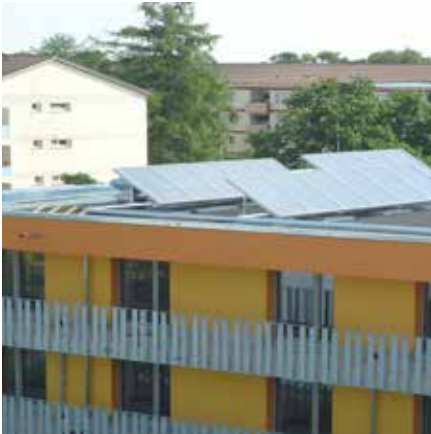
Abb. 159: Solarthermische Anlage in München
