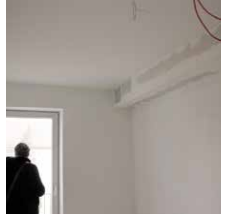
Abb. 110: Abkoffnung für die Abluft im Schlafzimmer
