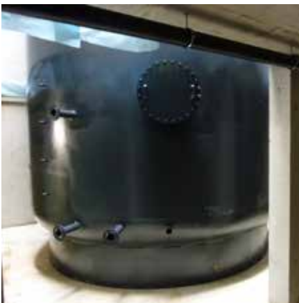
Abb. 160: Warmwasserspeicher in Ingolstadt Bauteil 1
