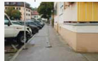
ausreichend breiter Gehbereich, allerdings Bauschäden und dadurch Stolperschwellen
