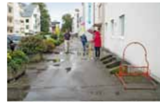
Engstellen und Stolperschwellen aufgrund von Bauschäden schränken Barrierefreiheit ein
