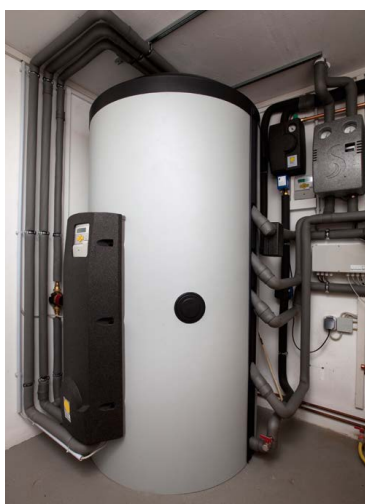
Heizungskeller mit Pufferspeicher
